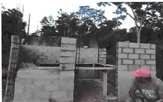
Foto 2: Remozamiento de cocina, sustitución de estufa, incluyendo chimenea y 1 plancha de metal
